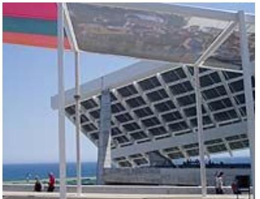
La instalación está situada junto a la gran placa solar del Fórum. (EM)
